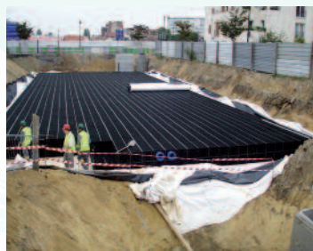
Bassin en Structure alvéolaire ultra légère (SAUL) - Asnières-sur-Seine
