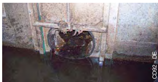
► Vanne guillotine - Bassin Camille Pelletan - Châtenay-Malabry
