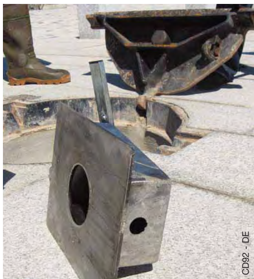
► Régulateur à effet siphon (démonté) - Gennevilliers
