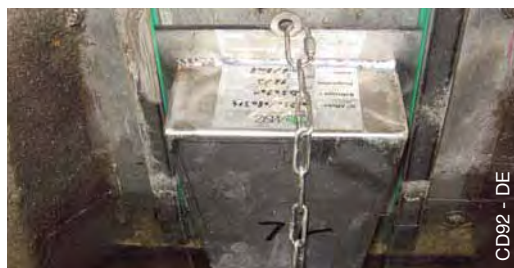
► Régulateur à effet siphon (en place) - Parc des Sévines - Gennevilliers
