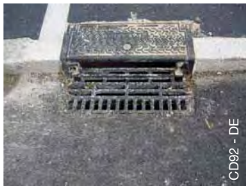
► Grille avaloir - Boulodrome - La Garenne-Colombes
