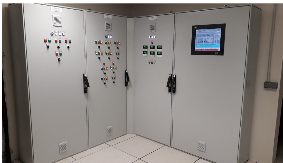
Figure 27 : TGBT de la station de pompage Vaugirard
