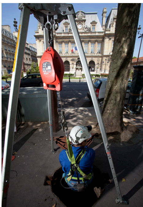
Figure 5 : Descente en égout (Neuilly-sur-Seine)
